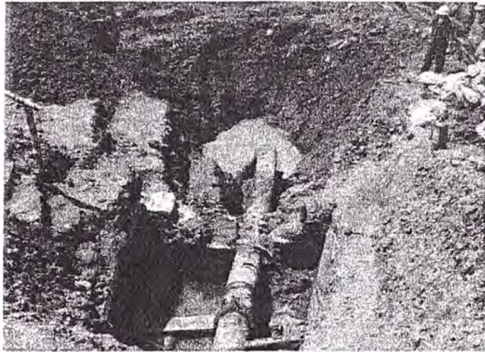
Vista del tramo fallado
