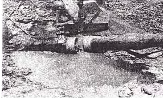
Vista de la rotura del ducto en el KP 126 Kepashiato
