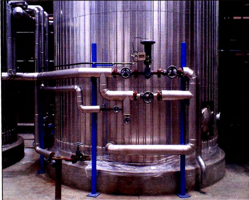
Figura n° 15: Estación de reducción y modulación de vapor
