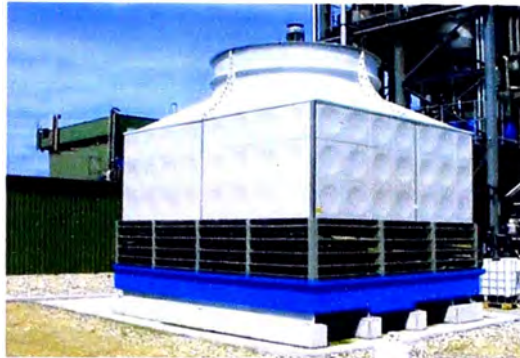
Figura 3.5.- Torre de Enfriamiento
