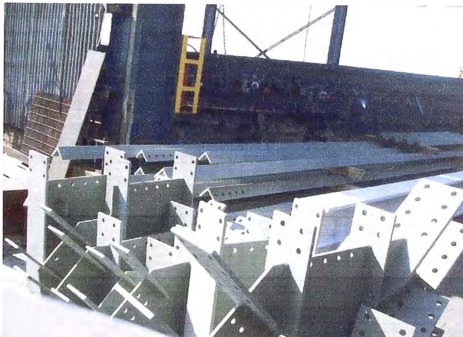
Fig. 3.14 Almacenamiento inadecuado de productos.
