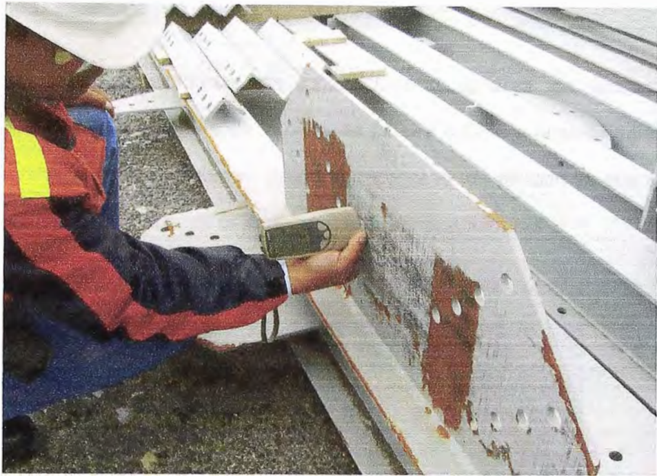
Fig. 3.10 Viga dañada por manipuleo inadecuado
