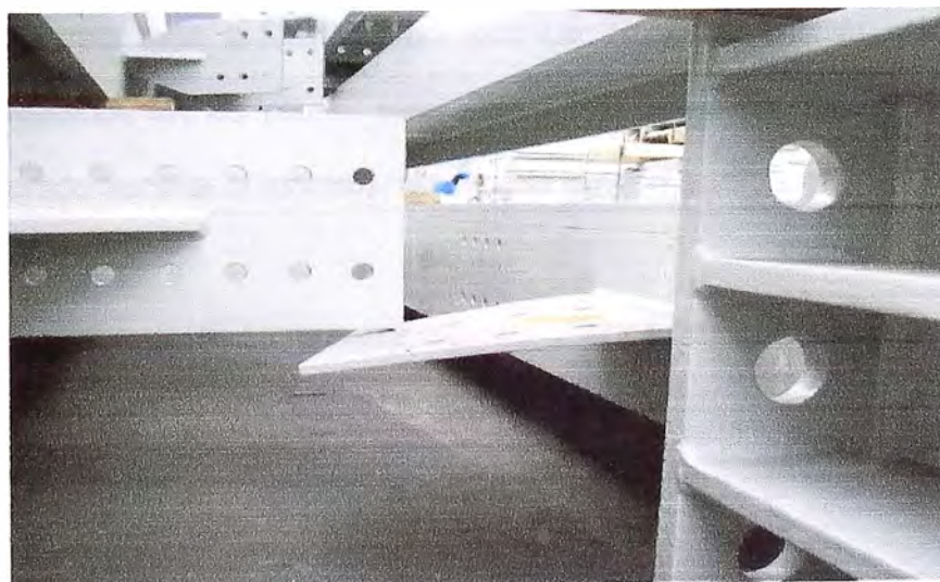
Fig.3.13 Viga almacenado en forma deficiente
