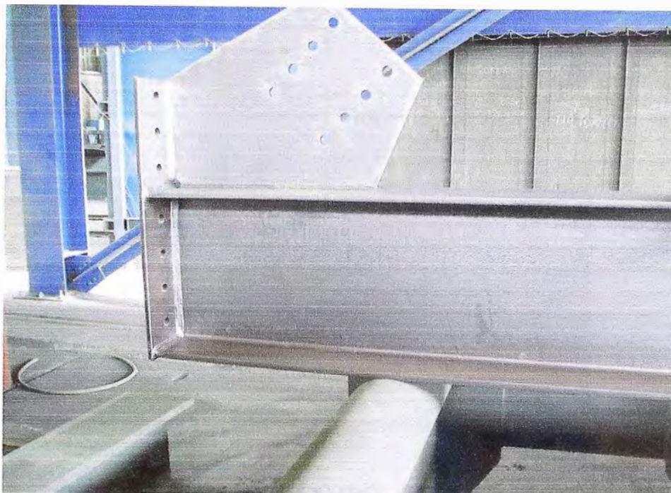
Fig. 3.5 .-Viga contaminada con pintura de acabado
