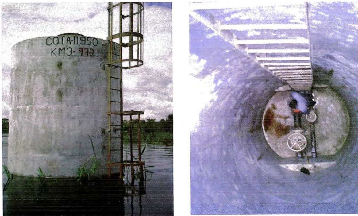
Figura 3.1: Estado Inicial del buzón exterior e interiormente
