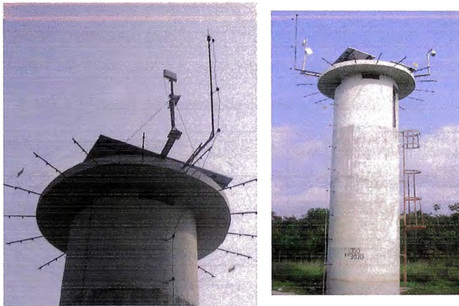
Figura 4.15: Detalles de los pararrayos instalados
