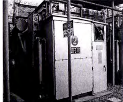
FIG 2.3 Transformador ITE N°2
