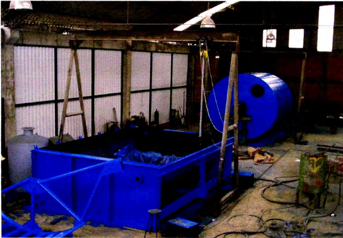
Figura 1.1: Planta de Filtración Industrial CIDELCO SAC
