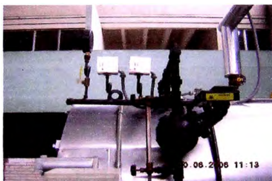
Fig. 5.8 Control de Nivel de agua
