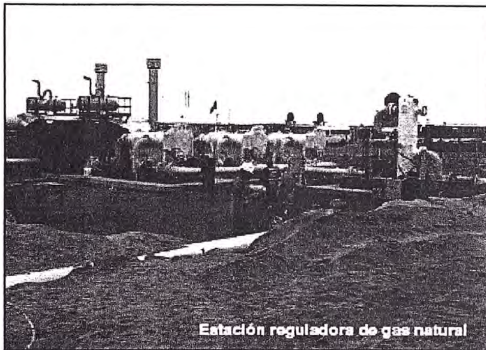
Foto N° 03.- Vista de la Estación Reguladora de gas natural.
