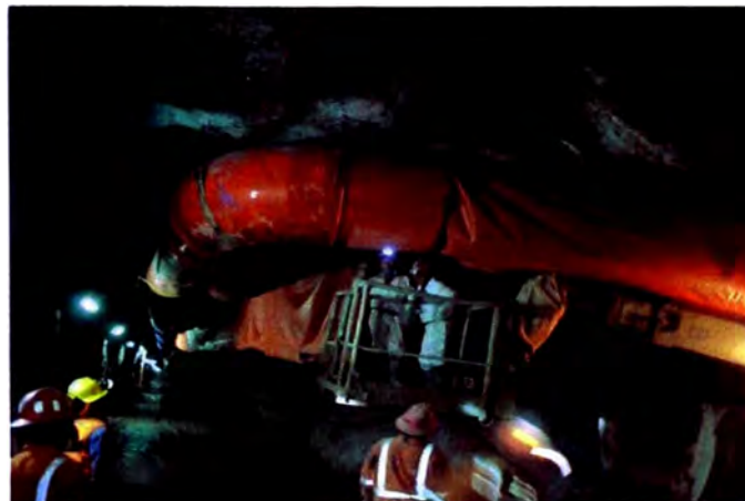
Figura N°23: Mangas de ventilación
