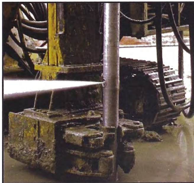
Figura 43: Jet de agua saliendo por la tobera del monitor.
