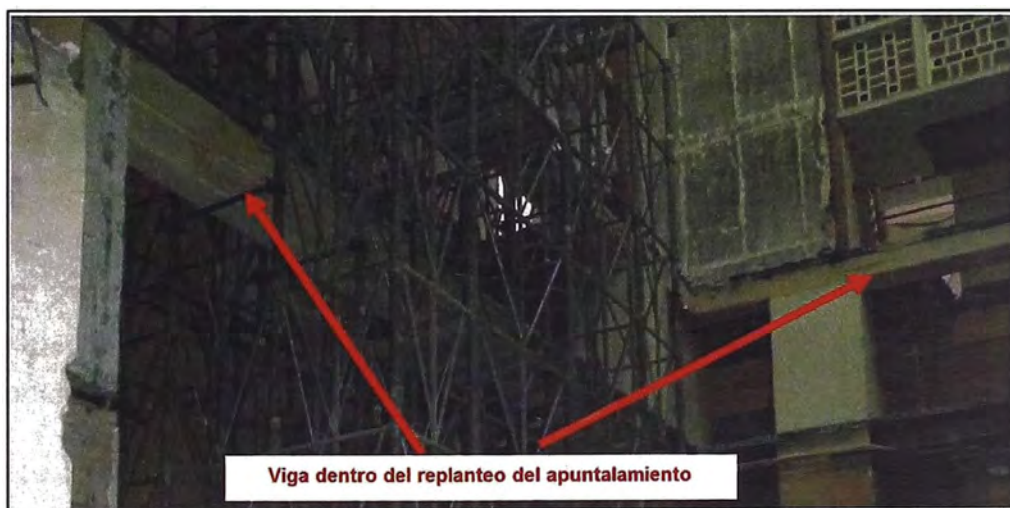
Figura 33: Vigas que incomodan el montaje de la torre.
