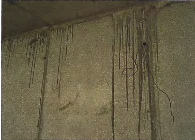
FOTOGRAFIA 2.4. – Encuentro de placa con losa de techo a desbastar
