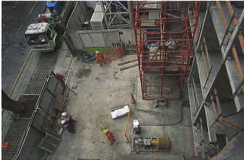
FOTOGRAFIA 2.2. – Elevador de carga marca EMDO
