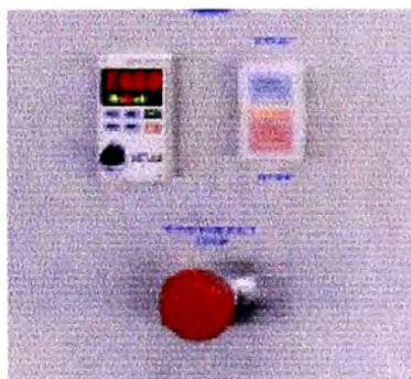
Figura 4.22: Fotografía del panel de control eléctrico.
