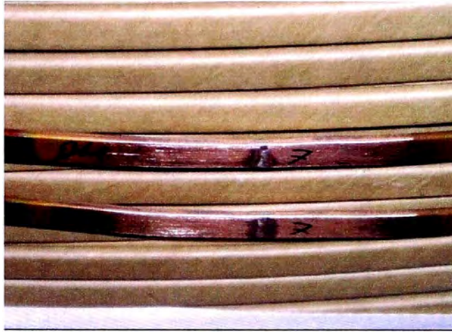
Figura N° 9.29. Buena practica, las soldaduras han sido firmadas por el operario responsable de la operación. Ver también la figura N° 4.16
