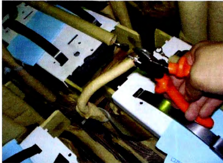
Figura N° 9.59 Una herramienta inadecuada esta siendo usada para prensar los conectores. Esta herramienta al no estar diseñada para la función genera sobreesfuerzo que a su vez genera desprendimiento de material, contaminando la parte activa
