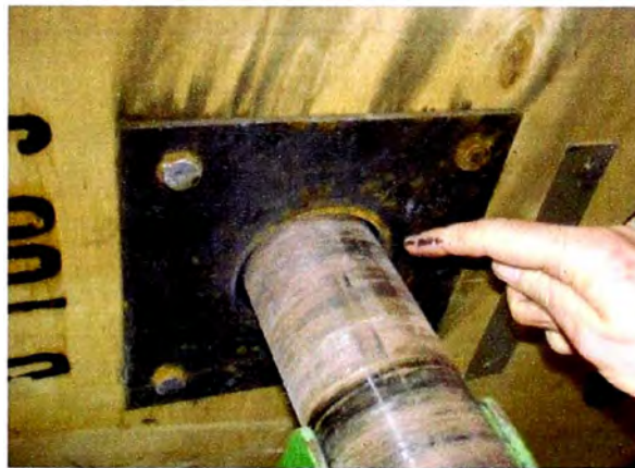
Figura N° 9.22 No debe permitirse el rozamiento de piezas de metal con metal. En la foto se ve que hubo fricción entre el carrete de cobre y la maquina bobinadora las escamas producidas son un riesgo de contaminación para las bobinas y puede conducir a una falla en pruebas
