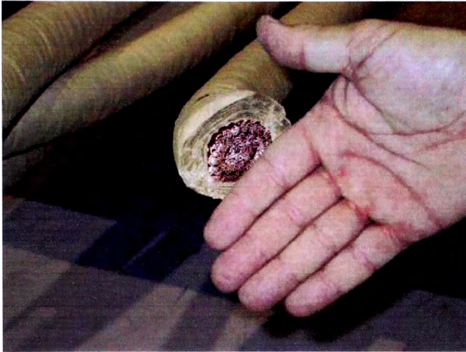
Figura Nº 5.25. Se ven pequeñas partículas de cobre en la mano. Hay un alto riesgo de contaminación al cortar cable flexible de cobre
