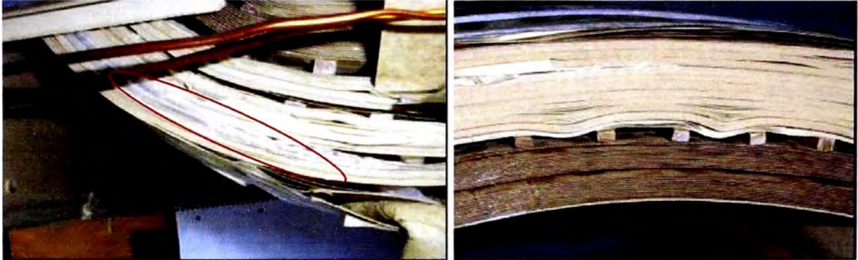
Figura N° 9.50 (Izquierda). Una bobina de alta tensión, tiene el ducto de refrigeración cubierto por una cinta adhesiva
