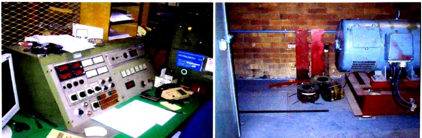
Figura N° 9.40 (izquierda). Orden y limpieza y percepción del cliente van juntos. La foto no da una buena impresión. Es urgente aplicar las técnicas del 5S. Note la cigarrera con la colilla de cigarro –a pesar de que en toda la planta esta prohibido fumar
