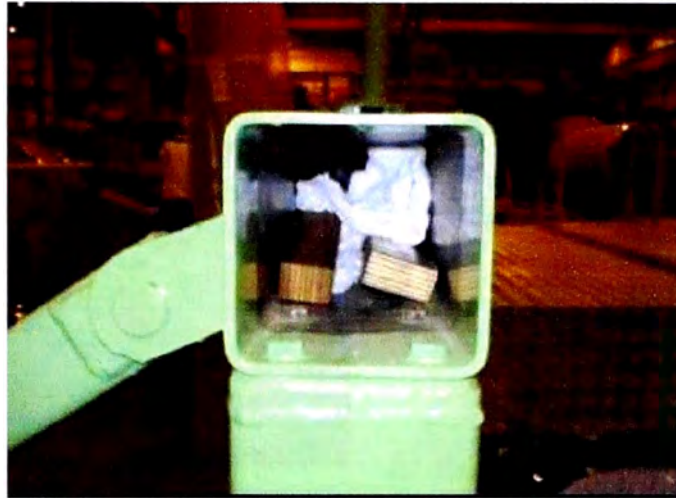
Figura N° 9.23. A todas las vigas de soporte deben soldársele tapas, pues pueden servir de basureros o almacenes de cachivaches. Esta foto fue tomada en el 2004.
