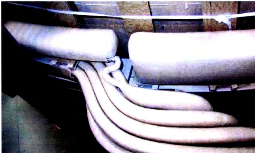
Figura Nº 3.7 Muestra la conexión de un anillo de protección de un bobinado de un transformador de potencia que esta muy deficientemente doblado lo que podría conducir a una falla en pruebas. Es obvio que la no conformidad es más que una señal de falta de conocimiento (responsabilidad de la dirección) más bien es un error de mano de obra
