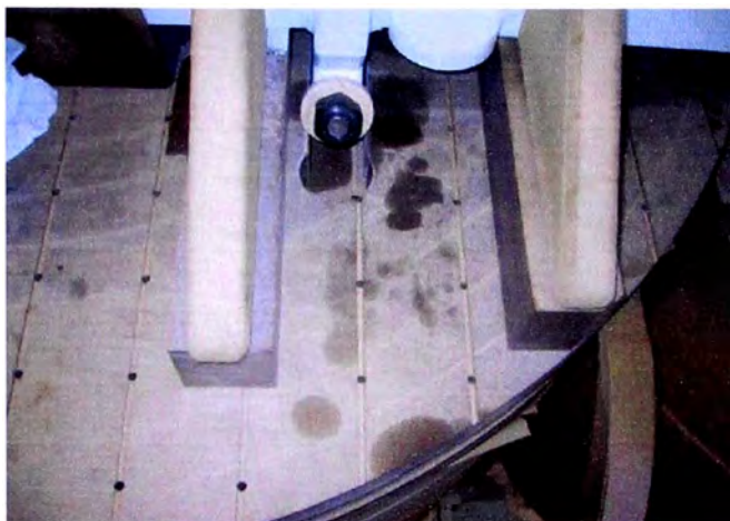
Figura N° 5.23 Muestra una fuga de aceite hidráulico (De los gatos hidráulicos usados para el prensado de bobinas) sobre la parte activa. El aceite hidráulico no es compatible con el aceite para transformadores; Por eso manchas de aceite hidráulico están absolutamente prohibidas en la parte activa
