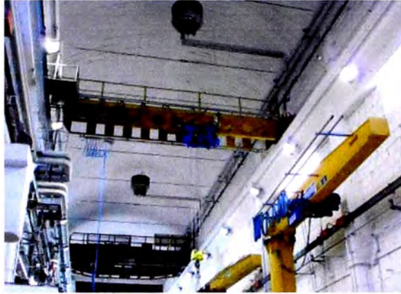
Figura N° 9.31. Inevitable pero muy peligroso. Grúas puente generan pequeñas escamas de fierro cuando sus ruedas friccionan con las rieles.
