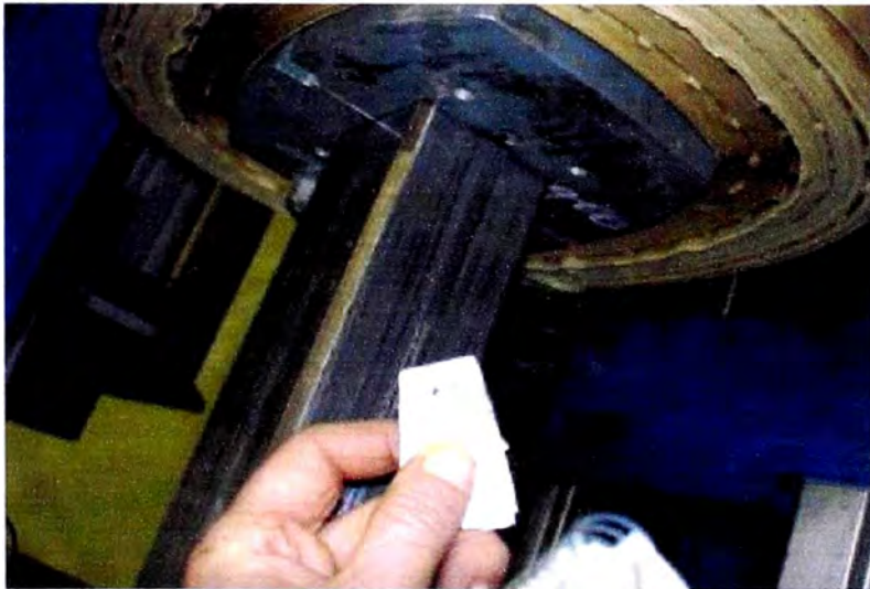
Figura N° 5.6. Una pobre practica en una máquina de bobinado de transformadores de distribución: partículas de fiero – la maquina no ha sido frecuentemente limpiada.
