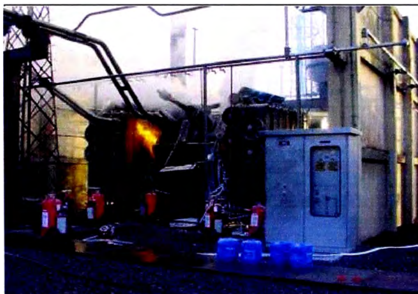
Figura Nº 3.1 Muestra un acontecimiento indeseable: un transformador de potencia incendiándose después de una salida de servicio forzada, resultando en un apagón para millones de personas.
