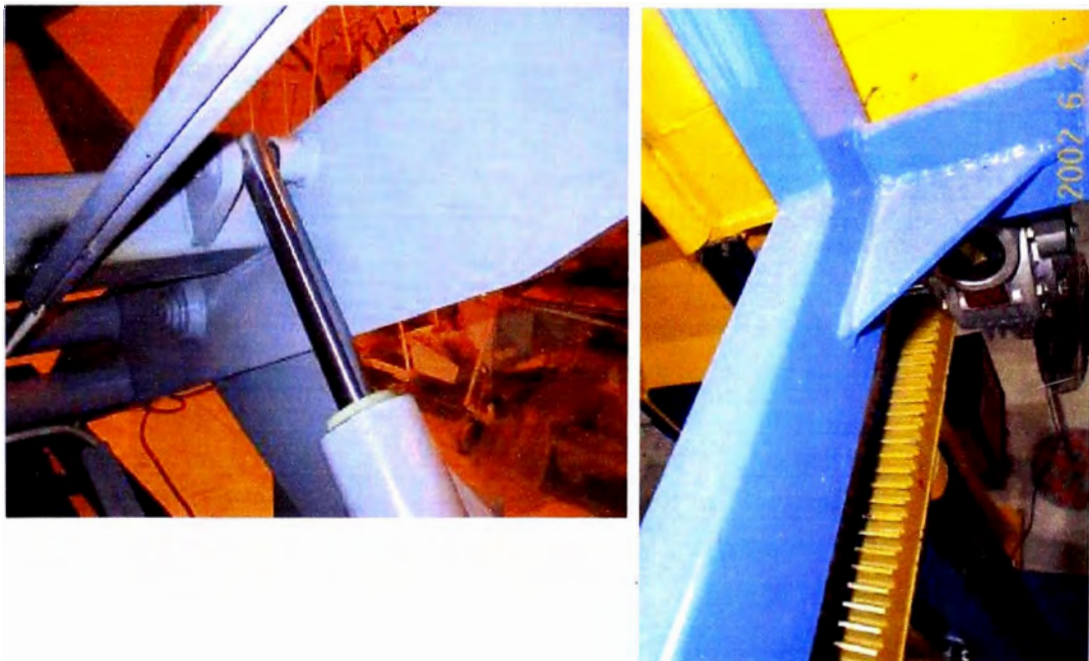
Figura Nº 5.29 y Figura Nº 5.30. Buena practica. A pesar de las partes móviles, no hay grasa que pueda acumular suciedad.
