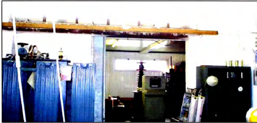
Figura N° 9.15 . Se muestra la sala de pruebas de una planta; esta da una pobre impresión necesita limpieza, pintura y orden.
