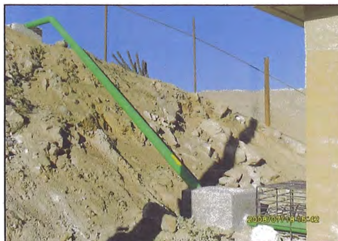
Foto N°4.45: Empalme de tubería al ingreso de la Caseta en Villa Cuajote
