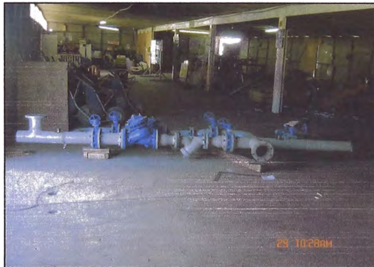
Foto N°4.5: Batería de Válvulas de Estación Reductora 1A
