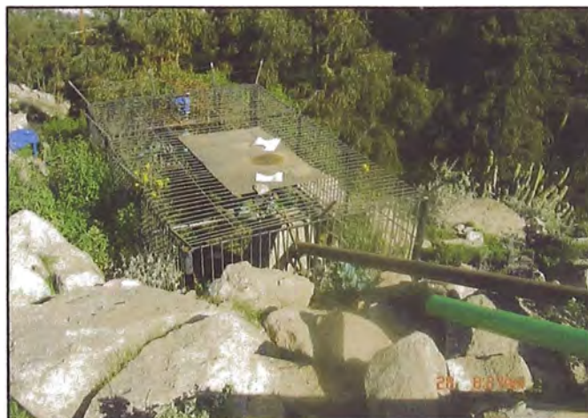
Foto N°4.28: Llegada a la Estación Reductora N°2
