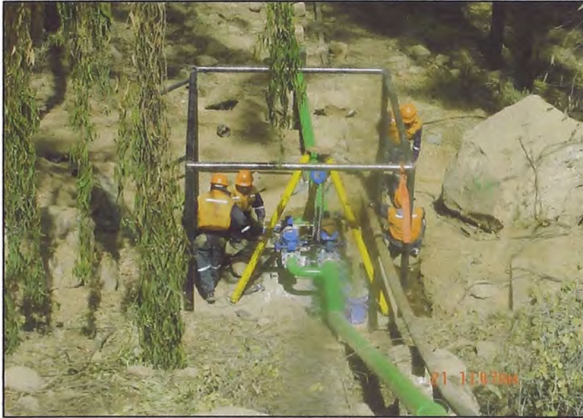
Foto N°4.35: Derivación al Tanque del Hospital pasando por ER N°4B
