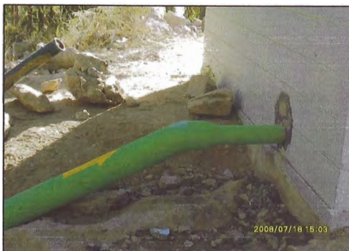
Foto N°4.43: Empalme de tubería al ingreso de la Caseta del Tanque del Hospital
