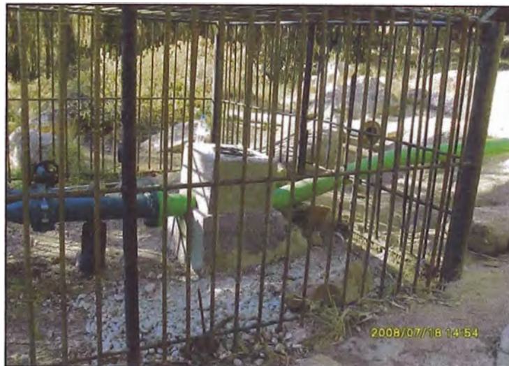
Foto N°4.40: Empalme a la llegada de la Estación Reductora N°3 (0+800)
