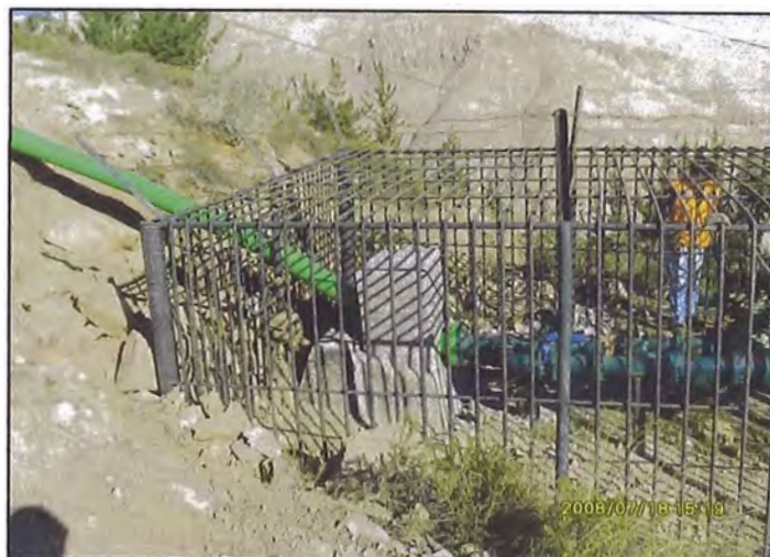
Foto N°4.42: Empalme de tubería al ingreso de la Estación Reductora N°4 (1+700)
