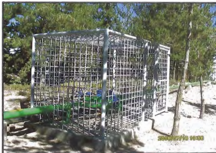
Foto Anx-V.20: Estación Reductora N° 5A
