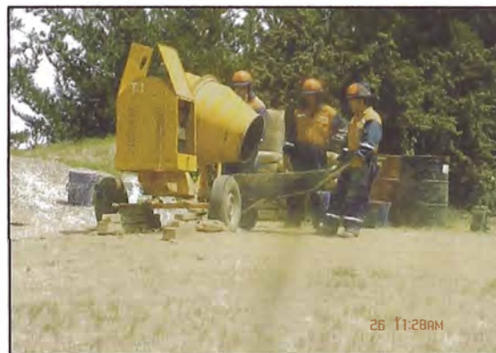
Foto N°4.19: Ubicación de mezcladora tipo trompo cerca de la válvula de venteo
