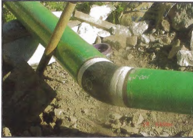
Foto Anx-V.13: Codo de 45° en Tramo Dos
