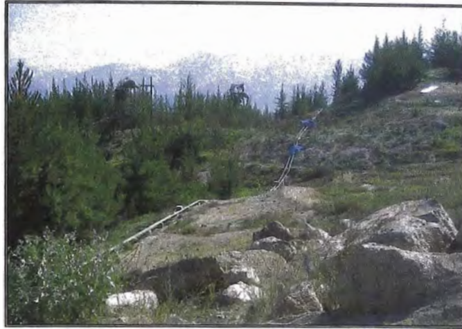
Foto Anx-V.16: Tubería Tramo Cuatro
