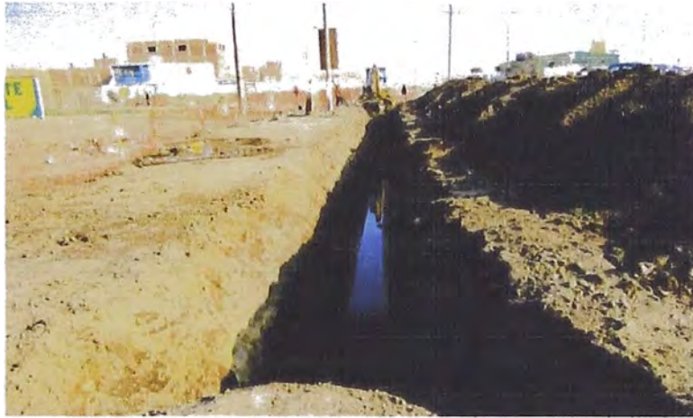
Figura 4.11.- Vista de Interferencias de redessanitarias por trabajo de terceros en el Tramo II
