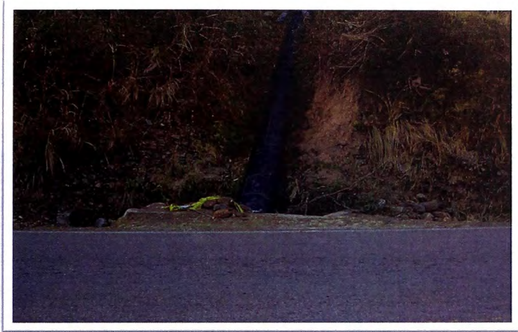
Figura 3.- Tubería forzada existente cruzando la carretera Lima Huaraz (vista frontal) (Fuente: GCZ Ingenieros S.A.C., AGO 2006)
