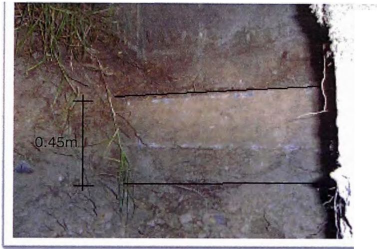
Figura 7.- Muro de contención existente (vista frontal detalle de zapata) (Fuente: GCZ Ingenieros S.A.C., AGO 2006)
