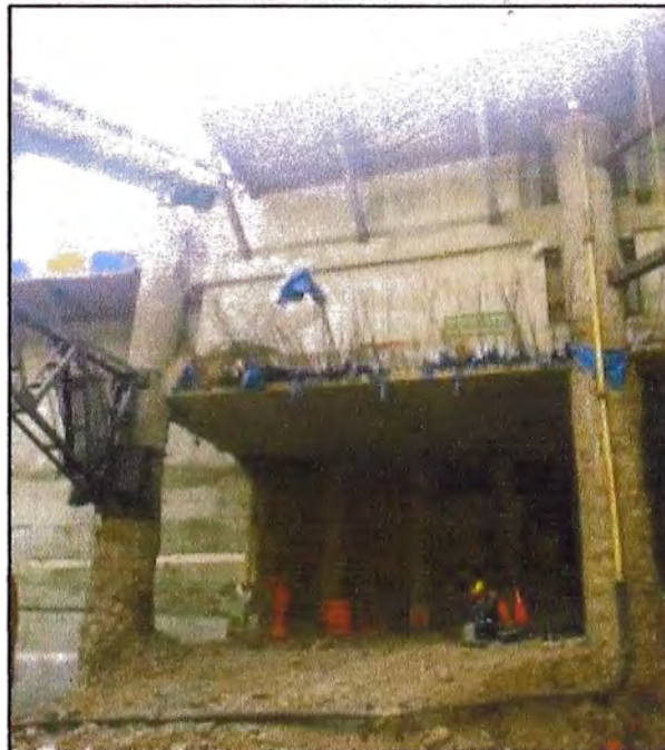
Figura 62: Sub estación construida en forma descendente
