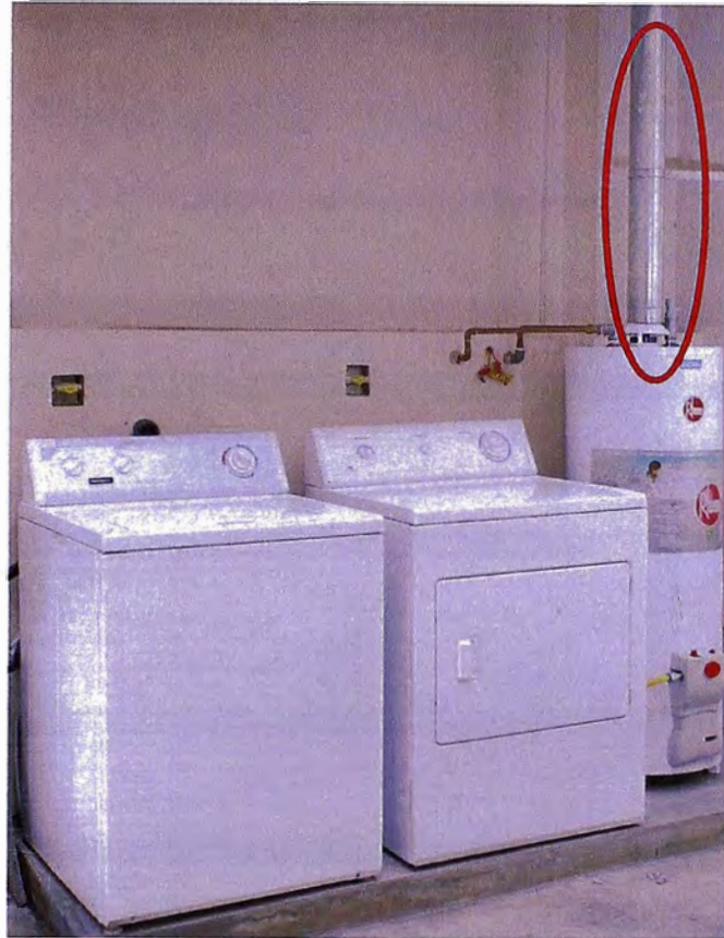
Termotanque tipo B con ducto de evacuación.
