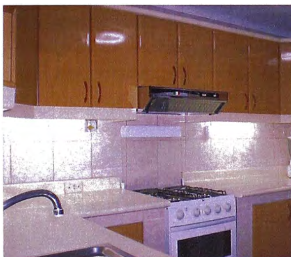
Figura N° 04: Tubería de PEALPE empotrada.
