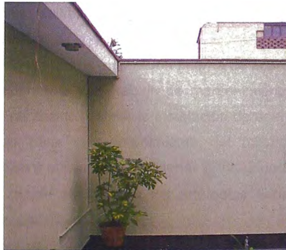
Figura N° 05: Tubería por conducto
