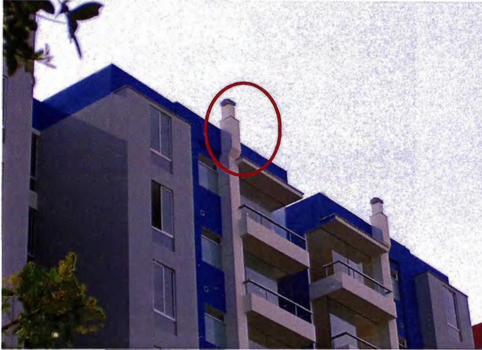
Ductos de evacuación colectivos – con chimenea.
