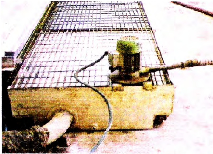
Figura 5.18 Bomba de caudal insuficiente
