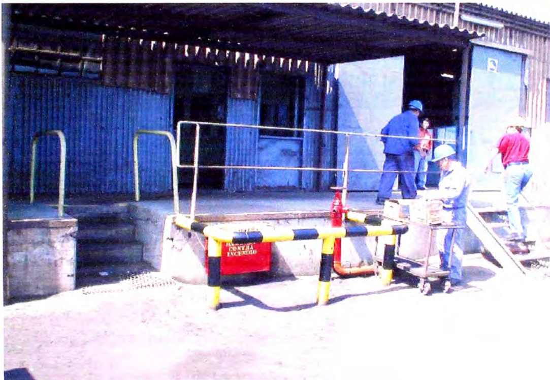
Figura 6: Protección contra incendios, hidrante ubicado en el exterior del almacén de San Nicolás
