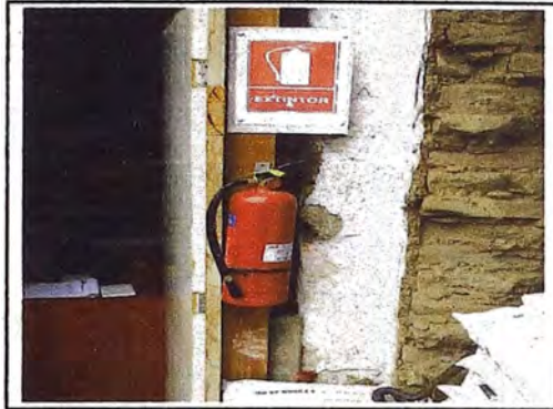
Figura N° 26: Extintor portátil, identificado en obra
