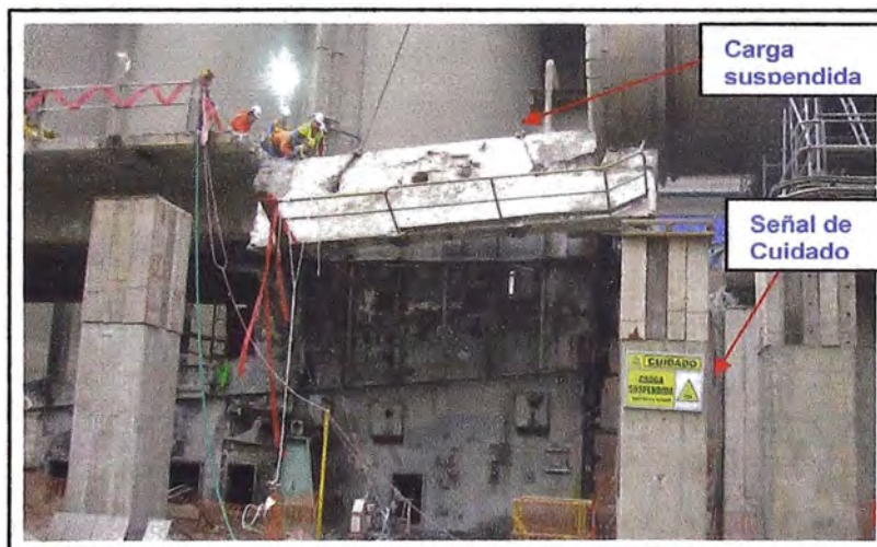
Figura N° 10: Carga suspendida por grúa
