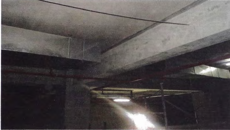
Fig. 75 Interferencia entre tuberías de ACI con ductos de IIMM
