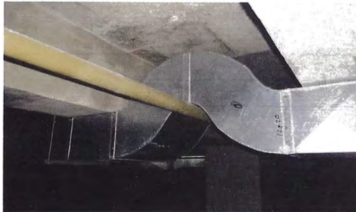
Fig. 77 Interferencia entre un ducto y una tubería
