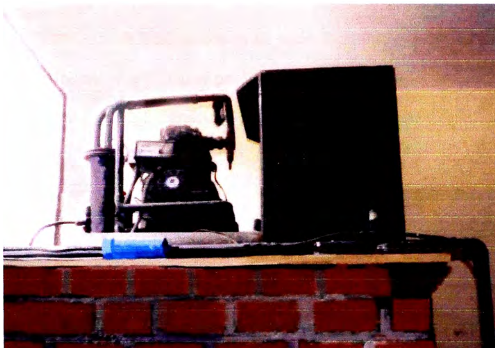
Figura N° 2.1: UNIDAD DE CONDENSACION
