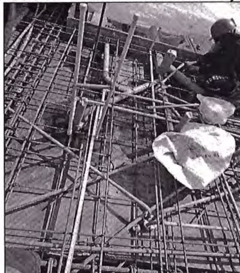
FIGURA. N° 4.7 Instalaciones Sanitarias y eléctricas
