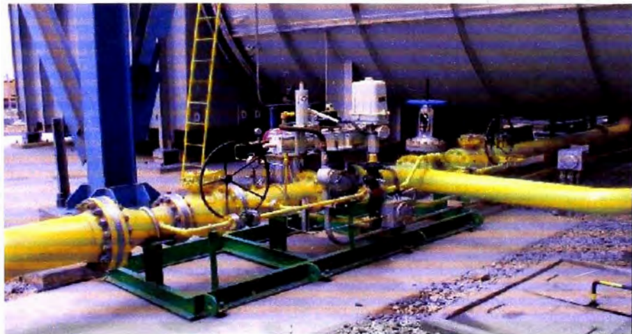
Figura 2.7: Sistema de Corte del suministro de Gas Natural TG 04
