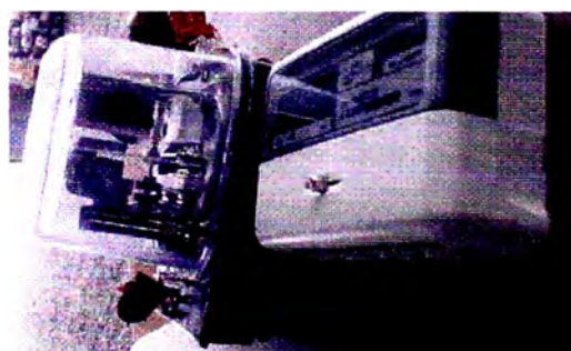
Foto de un medidor electromecánico y otro electrónico (tomada en ELSM)
