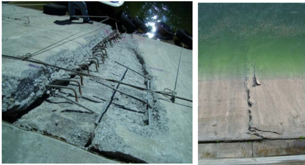
Figura 3.4 (a) Fisuras en la losa de concreto (aguas arriba) en la presa de enrocado Lesotho (Johannesson et. al, 2007) (b)
