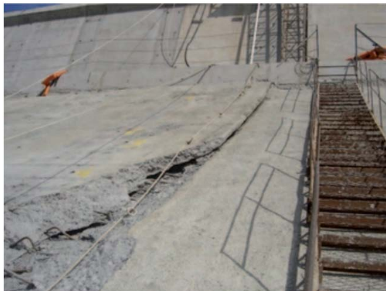
Figura 3.5 Roturas en la junta de compresión de la presa de enrocado Barra Grande (Pritchard, 2008)
