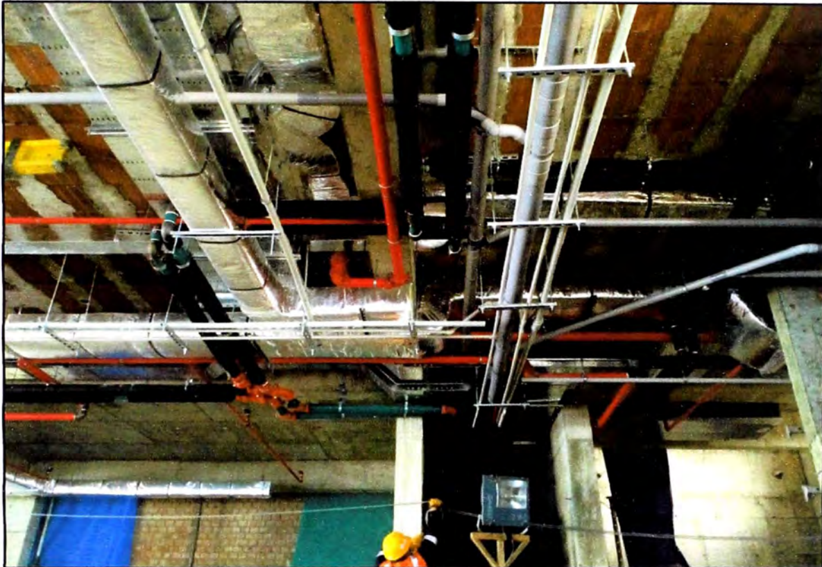
Figura N°5.30: Se muestra las instalaciones montadas en un techo típico según lo planificado en BIM, Cortesía Cosapi S.A
