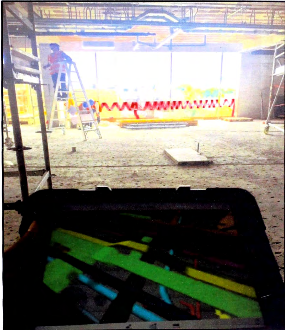
Figura N°5.31: BIM vs la Realidad, se observan las bandejas montadas tal cual el modelo BIM, Imagen cortesía Cosapi S.A
