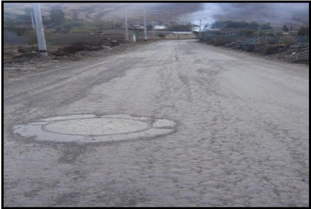
Foto 13: Se muestra el ripeado de la vía afirmada, cercana a la localidad de Punpunya
