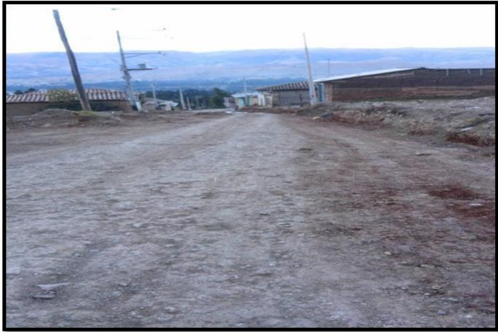
Foto 11: La vía afirmada genera exceso de polvo en época secano y exceso de barro en época de lluvia.
