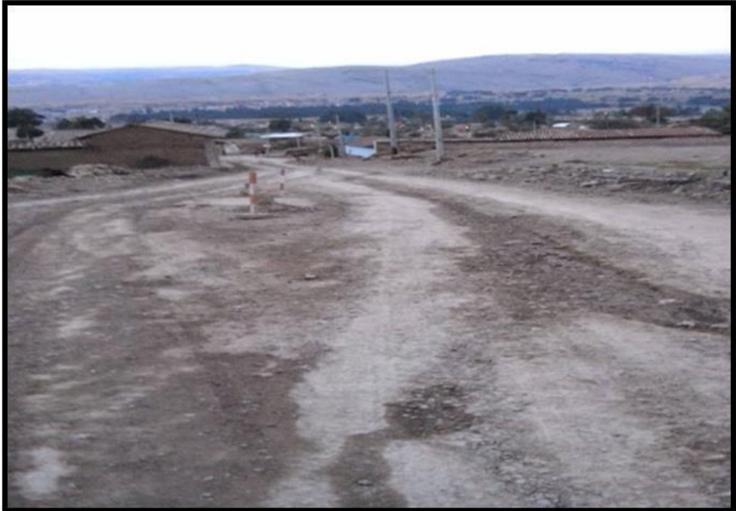
Foto 14: Se muestra vía afirmada afectada por el agua, lo cual deteriora a la vía, camino a la localidad de Chicche.
