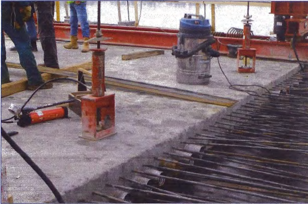
Figura 2.37 Destensado con cilindros huecos - Fuente: Ulma C y E, S. Coop
