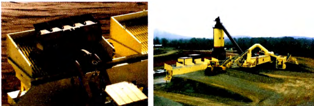
Figura 4.73 Los tabiques protegen a las tolvas de los impactos de los cargadores frontales
