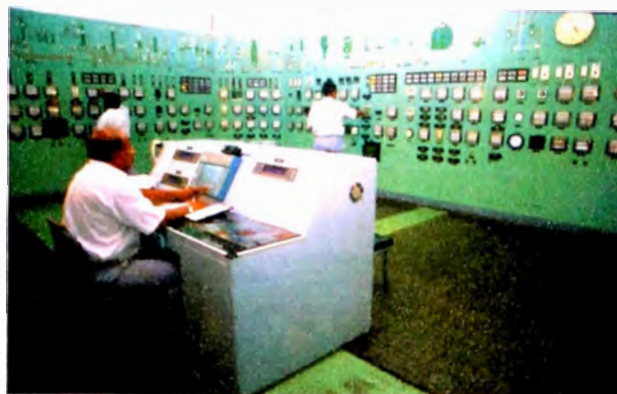
Foto 1.18 Sistema de control distribuido
