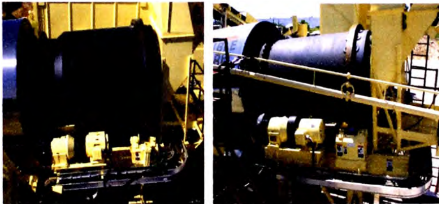
Foto 4.88 Ángulo de funcionamiento final del tambor mezclador Double Barrel y conexión del conducto de salida de gases al ciclón
