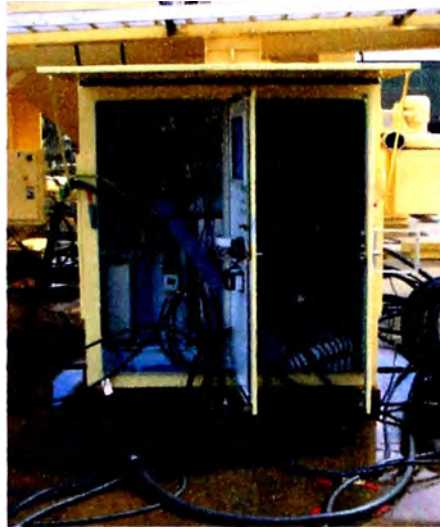
Figura 4.107 El tablero de alimentación permite conectar los cables rápidamente
