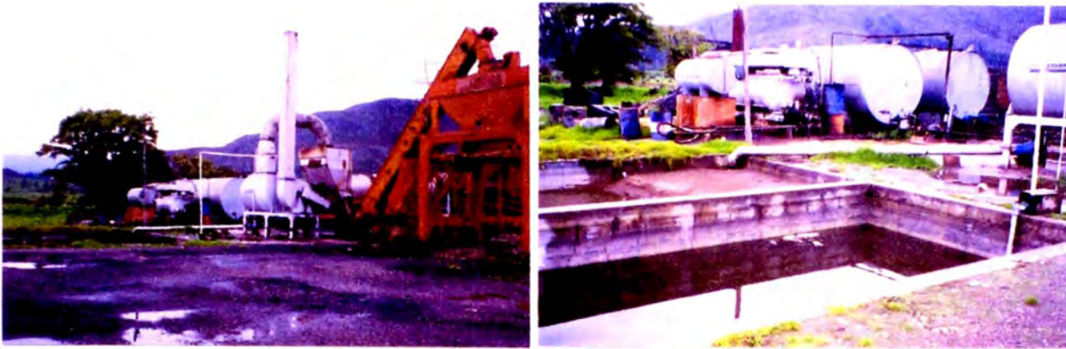
Foto 4.11 Sistemas colectores de polvos de tipo venturi por vía húmeda con bomba de agua, son ineficientes y generan problemas al medio ambiente
