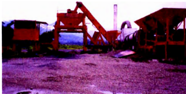
Foto 1.10 Planta de asfalto ciber de flujo paralelo ubicada en la Victoria-Cajamarca
