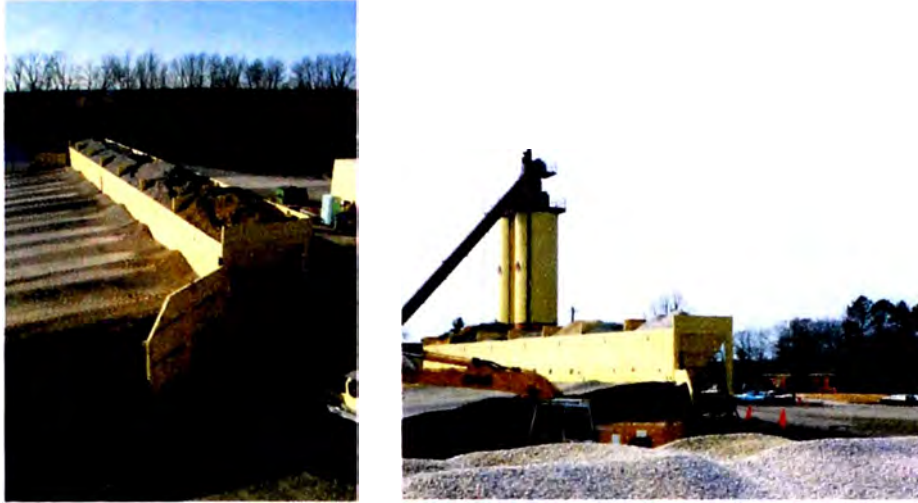
Foto 4.78 Tolvas de agregados en frío con tabiques articulados incorporados
