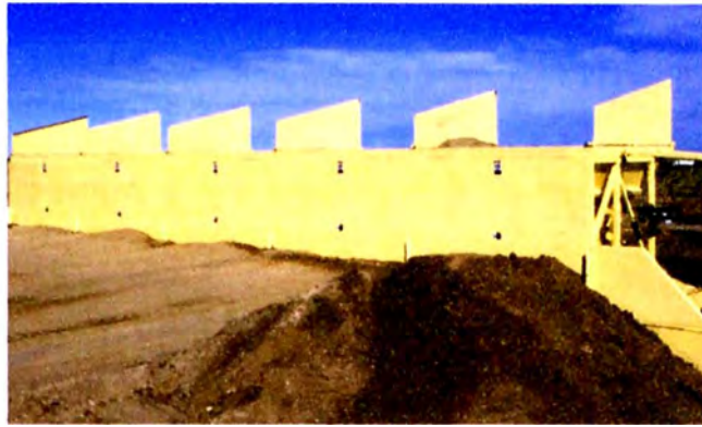
Foto 4.72 Tabiques de acero incorporados en las tolvas
