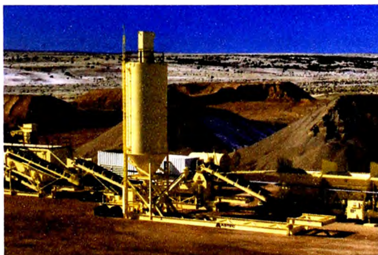
Figura 4.101 Silo para aditivo
