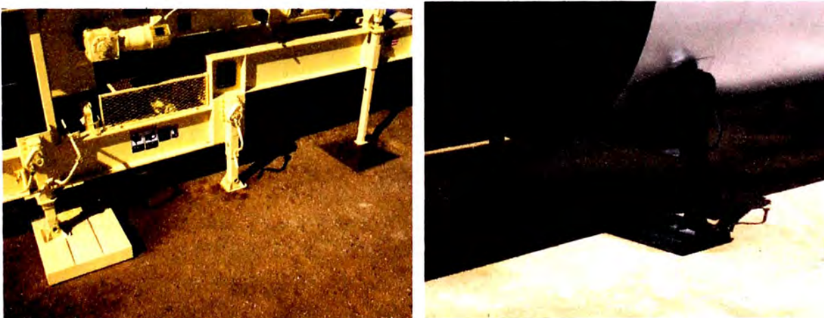
Foto 4.69 Cimentación de los equipos sobre suelo firme y compactado
