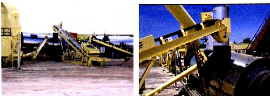
Foto 4.89 Zona de ingreso del RAP al tambor mezclador Turbo Double Barrel
