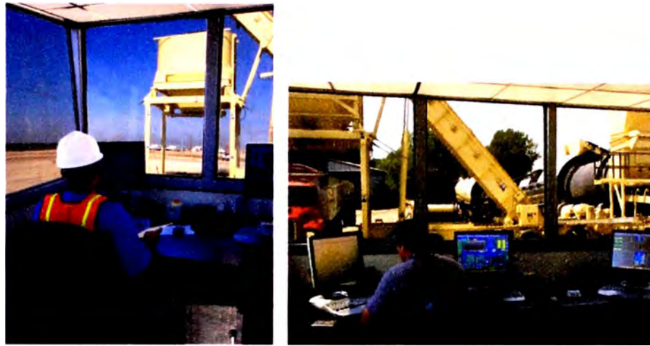
Foto 4.113 Todos los tableros de control vienen completamente armados y con el alambrado instalado
