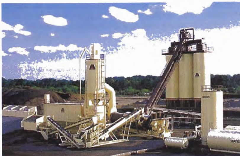
Foto 6.29 Planta de Asfalto Six Pack Portátil Double Barrel de ASTEC Modelo PDB 400
