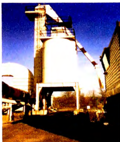
Foto 3.38 Silo de mezcla asfáltica y faja transportadora
