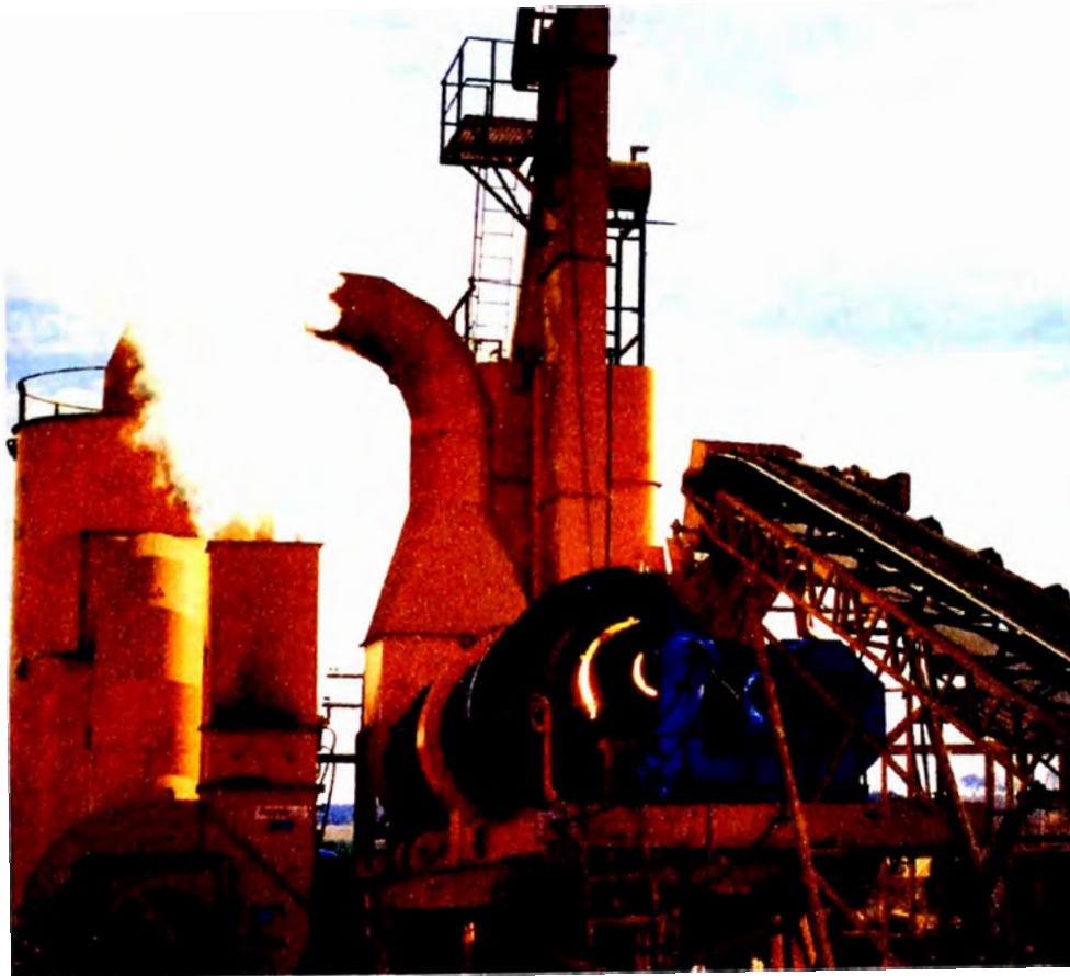
Foto 4.15 Las plantas de asfalto con tambor mezclador de flujo paralelo producen altos niveles de polución debido a las temperaturas muy elevadas en la chimenea
