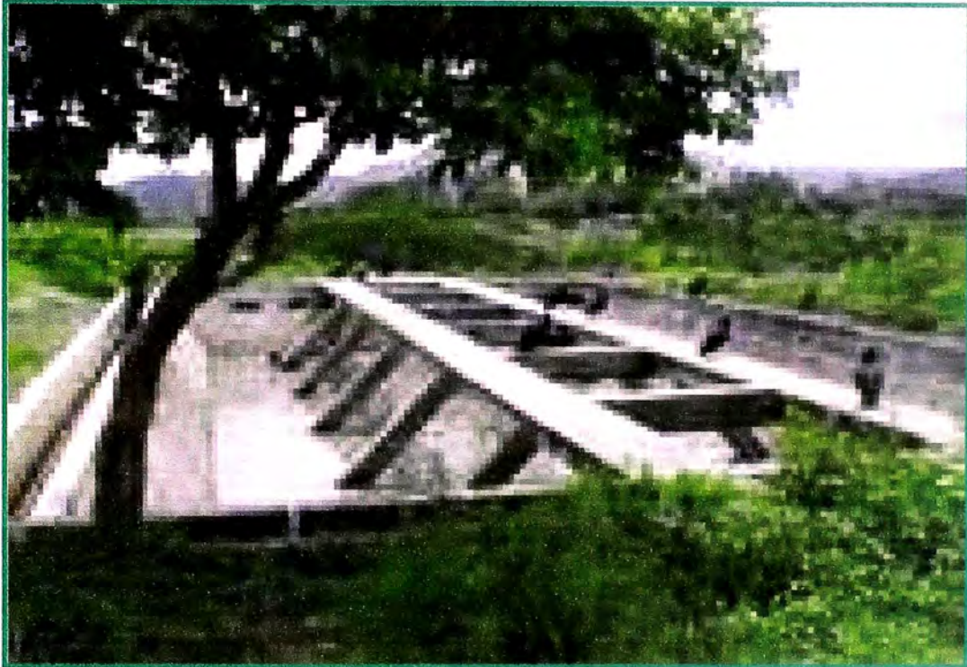
Figura N° 9: Vista de un sistema Tanque Imhoff
