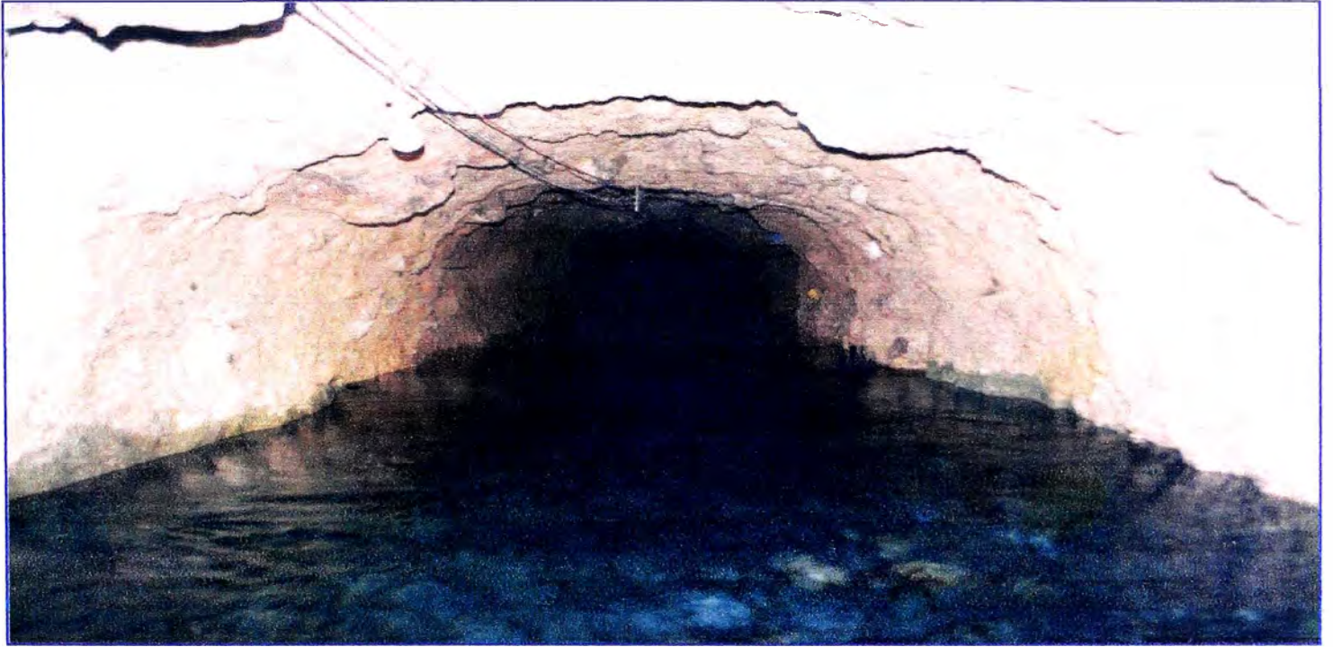
Fotografía N° 3: Ocurrencia de agua en medios fracturados
