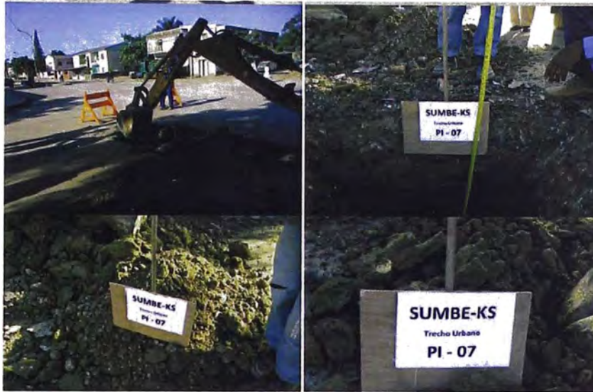
Fotografía N°4.3. – Vistas de la Calicata PI-07 en el barrio de Sumbe
