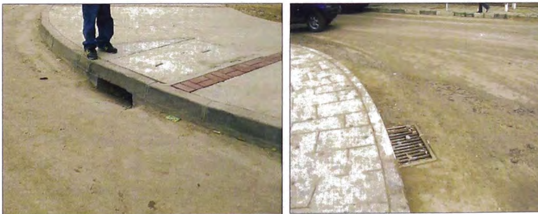
Fotografía N°2.2.- (Derecha) Sumidero de solera (Izquierda) Sumidero de Fondo. Ambos ubicados en Lobito – Angola
