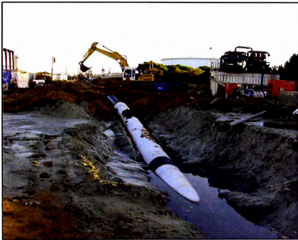
Figura N°4.6.- Salida de la tubería producto de 16'' de diámetro.
