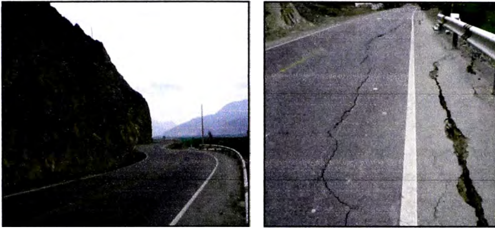
Figura 13.- Zona de deslizamiento del Talud.
