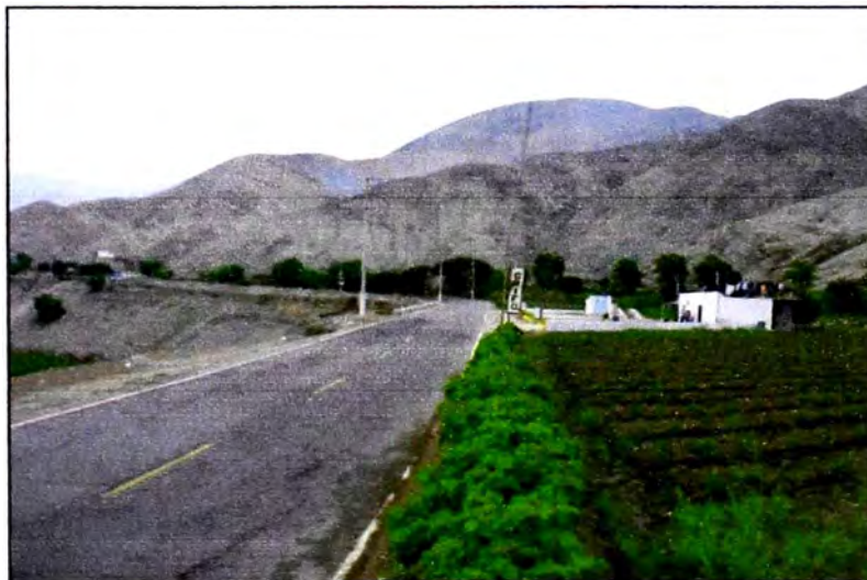
Figura 14.- Erosión del talud por humedecimiento
