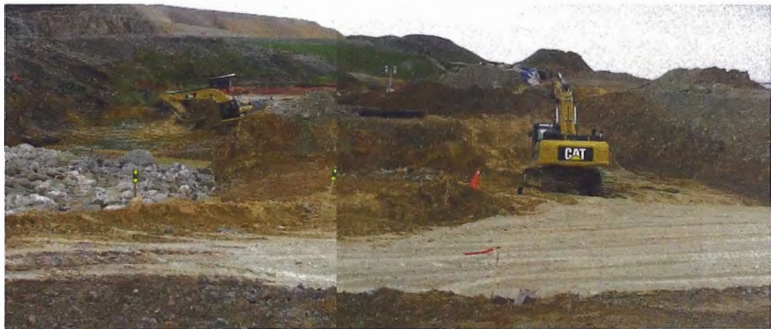
Figura N° 26.- Situación encontrada de la Excavadora en terreno saturado
