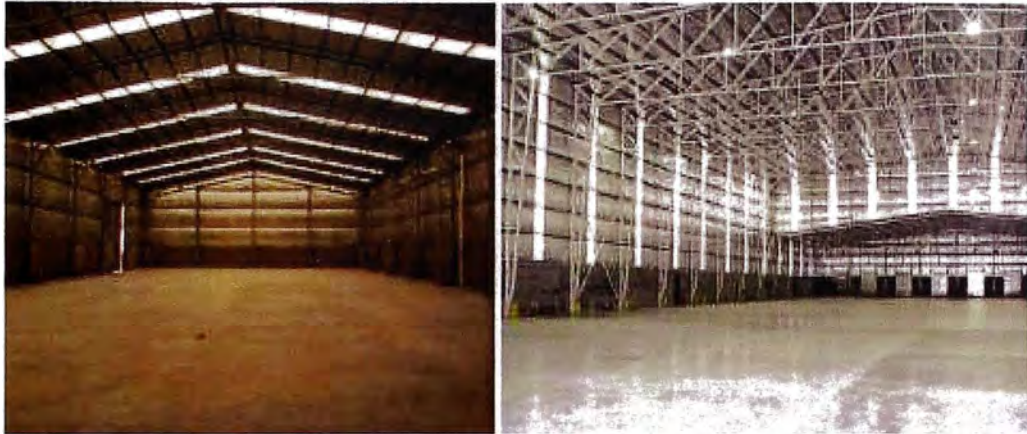
Figura 1. Techo a dos aguas con pórticos de alma llena con pórticos de alma llena.
