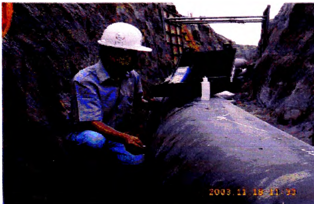
Verificación por ultrasonido de espesor de tubería doblada, ubicada en el City Gate
