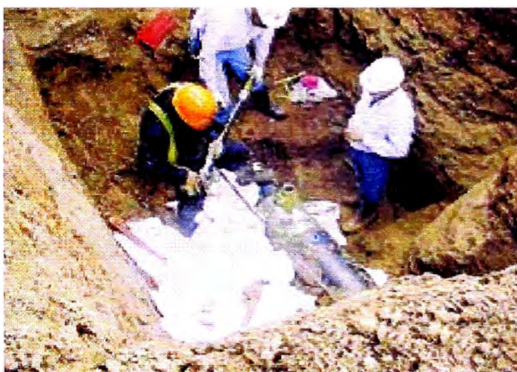
Figura 3.4 : Rotura del gasoducto en la Provincia de la Convención
