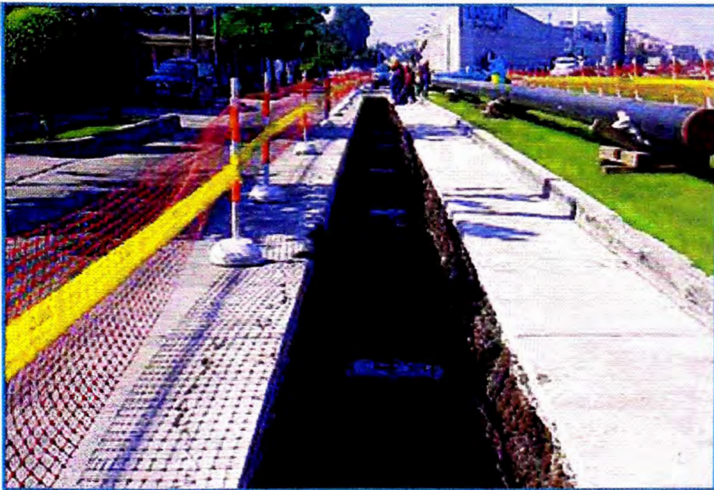
Foto 2 : Desfile de tuberías sobre la ruta y preparación de zanja para gasoducto.
