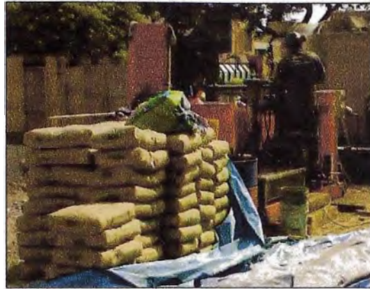
Figura 71 - Operador de la inyectora
