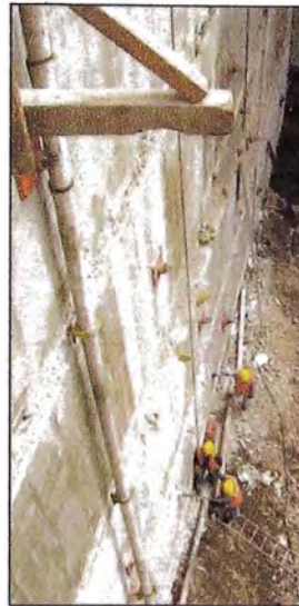
Figura 42 - Tubería de impulsión de concreto adosado al muro
