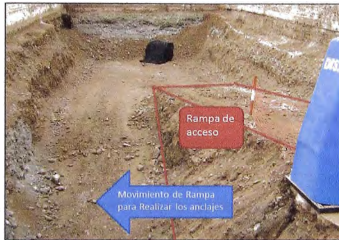
Figura 36 - Movimiento de la rampa de acceso
