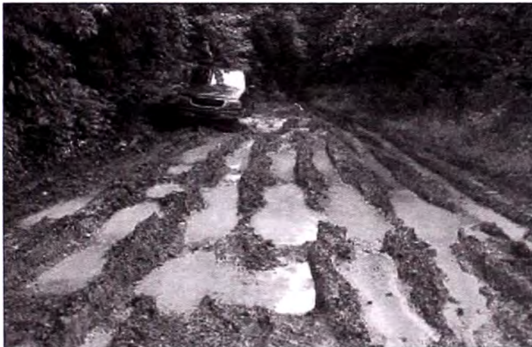
Figura 5.6 Ahuellamiento en una vía no pavimentada
