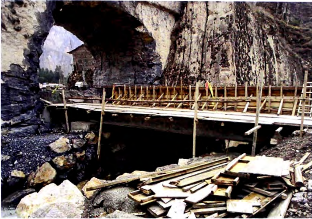
En esta foto se aprecia las una de las 05 vigas metálicas de un puente demolido que fueron utilizados como parte del falso puente
