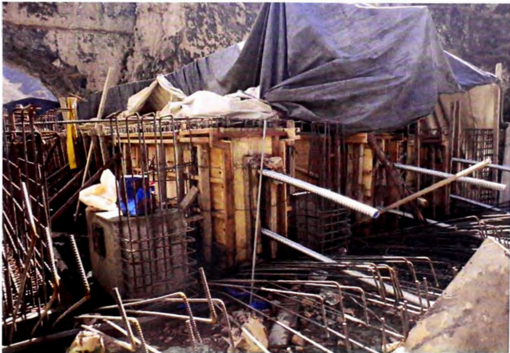
En esta foto se aprecia los ductos que soportaran los tendones en las vigas
