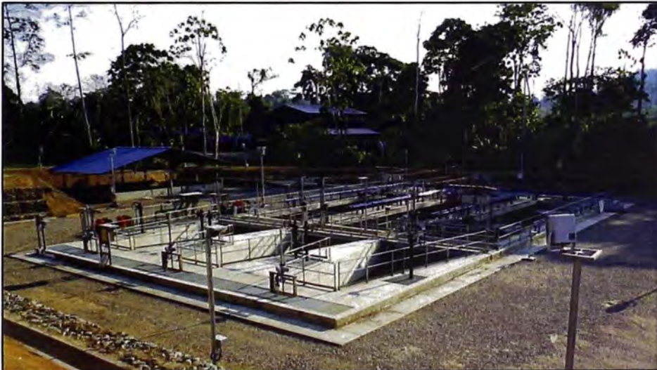
FIGURA 17: “Vista lateral de la Pileta API”.
