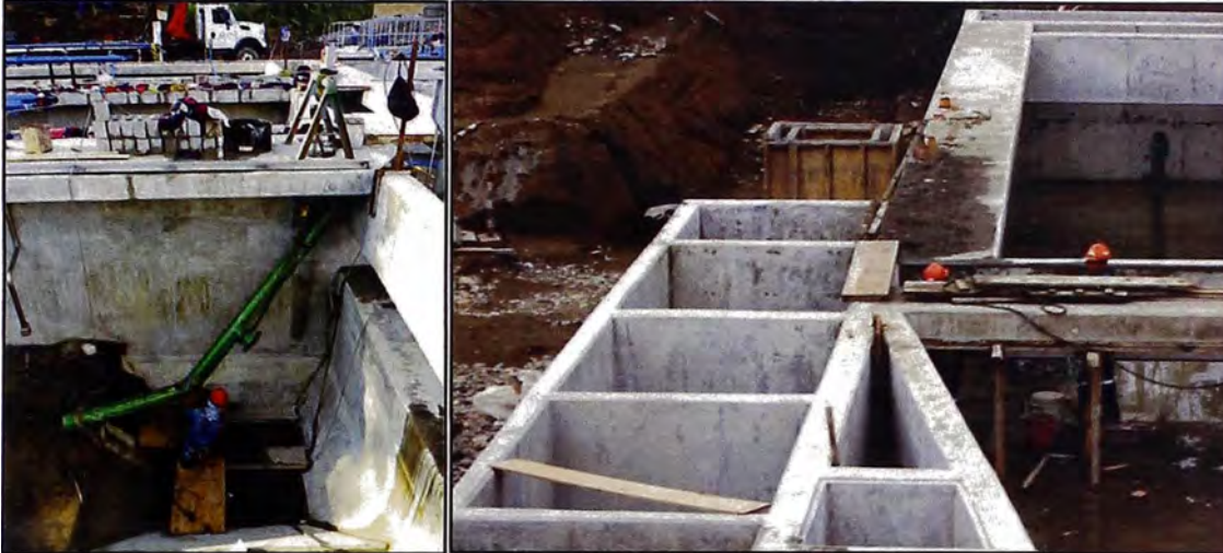
FIGURA 9: “Tolva de lodos y Fosa de Lodos”.
