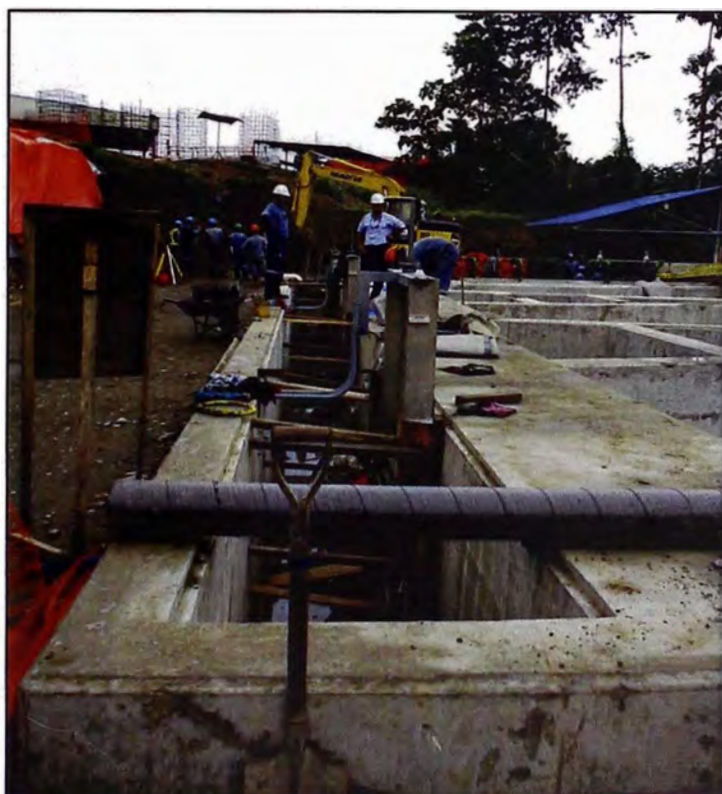
FIGURA 4: “Ingreso: “Ingreso de agua de lluvia a pileta API”.
