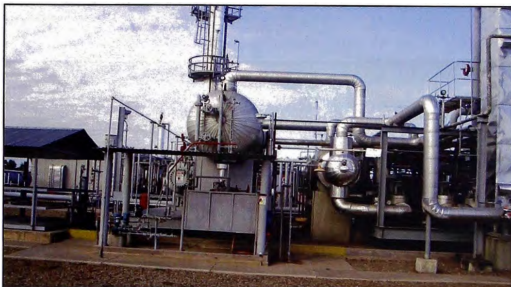
FIGURA 3: “Vista perfil de planta de gas Río Grande”.
