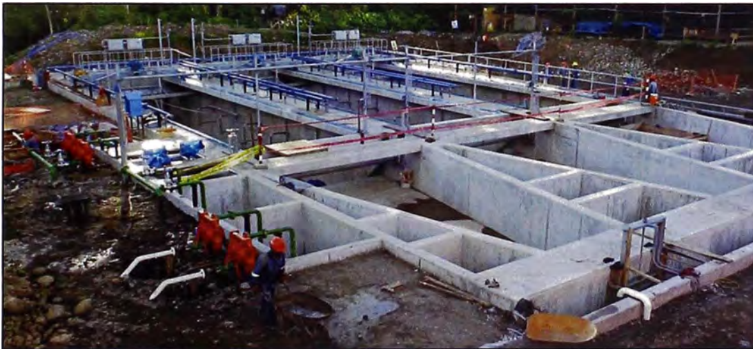
FIGURA 10: “Vista general de pileta API”.
