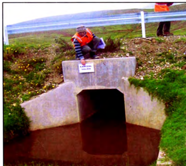
(Fuente: Elaboración Propia, 2010) Figura 4.4 Vista aguas abajo de la alcantarilla 77+780
