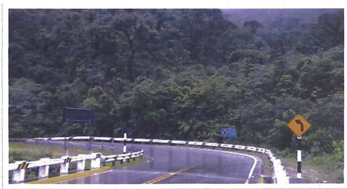
Figura N° 1.4 Espejo de agua sobre la carretera, Km 280.
