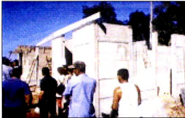
Figura N° 1.21.-Montaje de elementos con el sistema Sancocho -Fuente: Boletín Técnicas Alternativas en Viviendas-Programa CYTED-UNESCO
