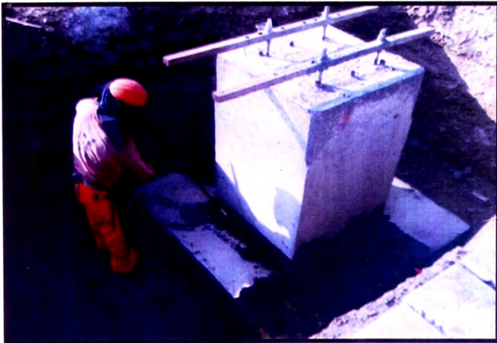
Figura N° 3.6: Se procede aplicar la cobertura a la superficie lateral de la zapata
