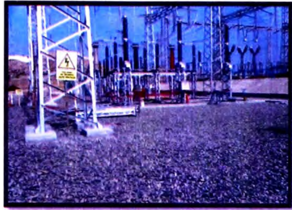
Figura N°1.3: Vista interna de la SE
