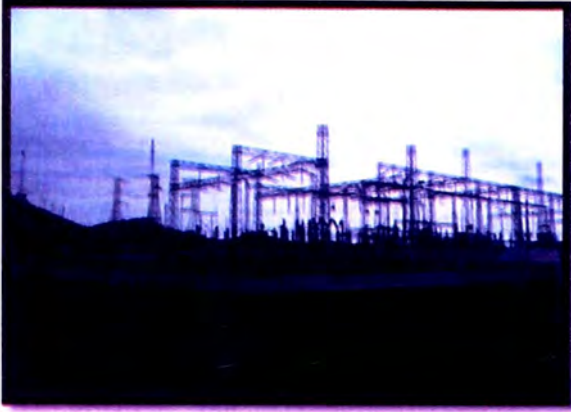
Figura N°1.2: Vista externa de la SE
