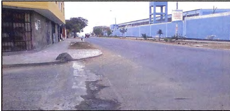
Foto N°20.- Estado de la avenida Edilberto Ramos, Pamplona Alta.
