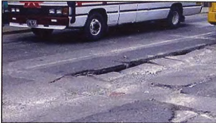
Foto N°11.- Mal estado de las pistas, avenida San Juan
