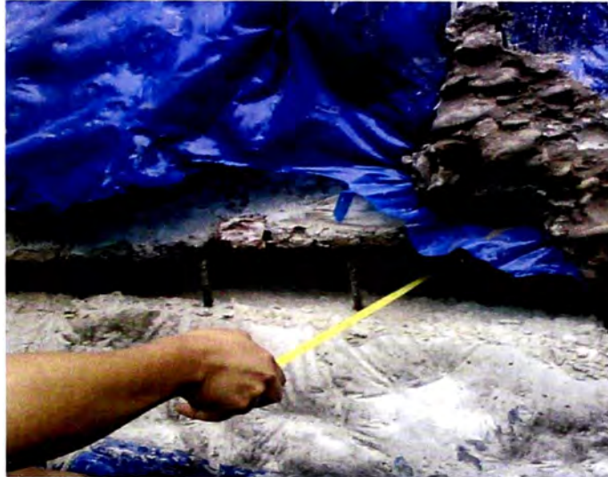
Figura 3.02 Evaluación de las dimensiones de las cangrejas generadas en el encuentro de anillos del muro pantalla
