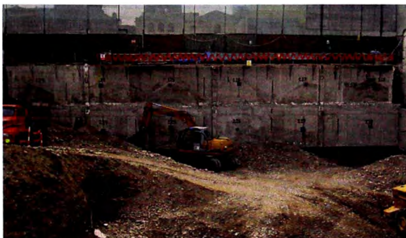
Figura 5.04 Excavación de las banquetas (Talud natural) y los paños de muro a vaciar intercaladamente en la zona 2 frente a la Av. Arequipa del Edificio comercial Basadre
