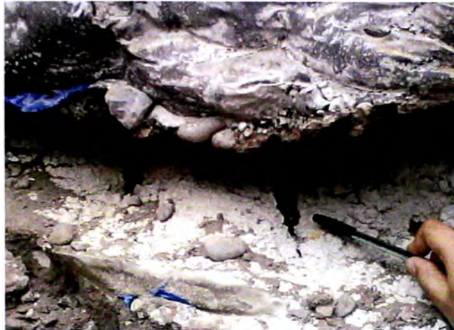
Figura 3.03 Evaluación del grado de corrosión de la armadura de acero
