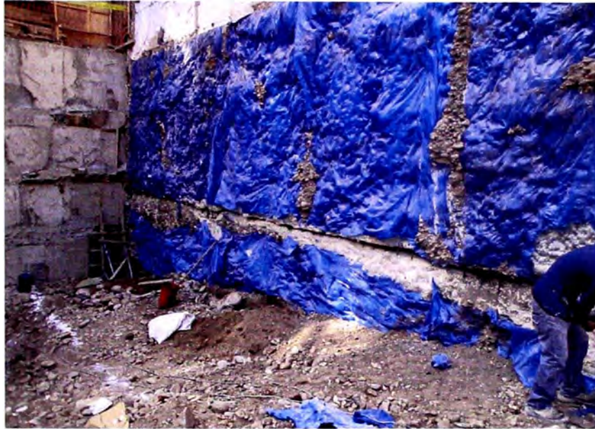
Figura 1.04 Vacío a lo largo de la unión del encuentro de anillos del muro pantalla anclado del Edificio Jacinto Lara
