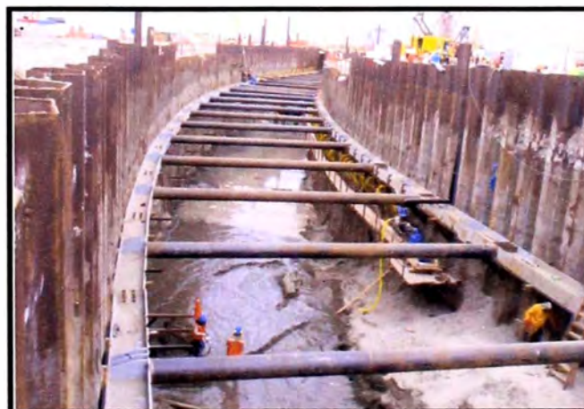
Figura 5.16: Sector 01 en zona terrestre, se ve el uso de un solo nivel de arriostre
