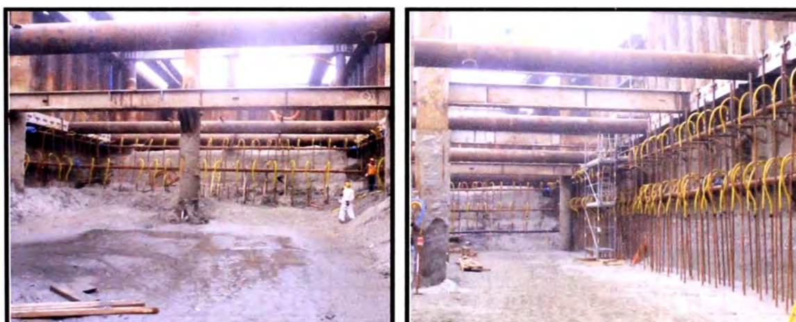
Figura 5.23: Se retira el agua en los primeros 30m – 35m del interior de la estructura de tablestacas, nivel -7.00m
