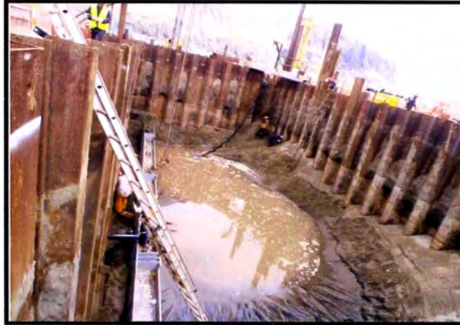
Figura 5.12: Presencia de agua subterránea, nivel freático alto.
