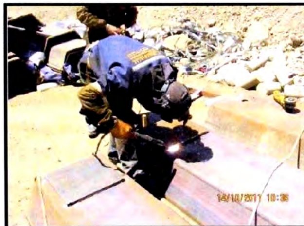
Figura 2.12: Colocación de planchas de refuerzos en los extremos de las tablestacas para la instalación en el proyecto de Hidroeléctrica de Cheves – Churín
