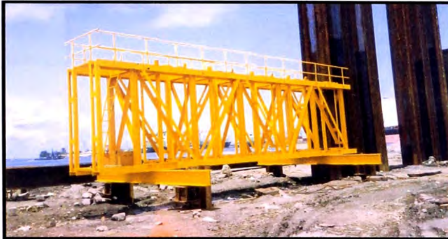
Figura 2.7: Guía de Instalación de 02 niveles + pasarela de transito de personal
